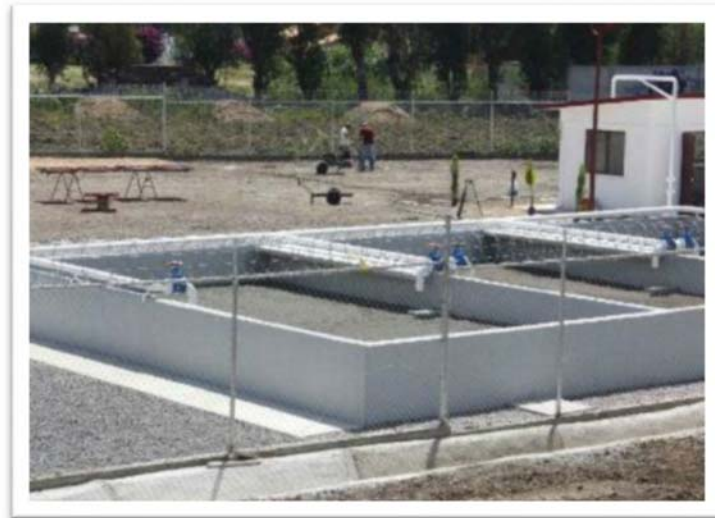
Figura 2. Planta de tratamiento de aguas residuales en Querétaro.
