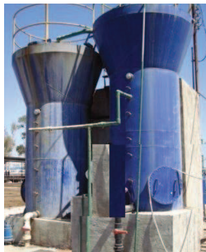
Figura 6.2. Reactor anaerobio UASB de la planta de tratamiento.
